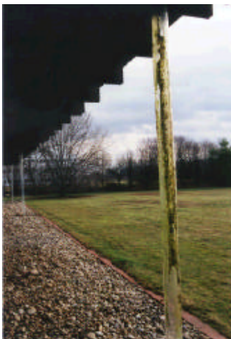
Abbildung 11: Ablaufrohr ohne Algizid
